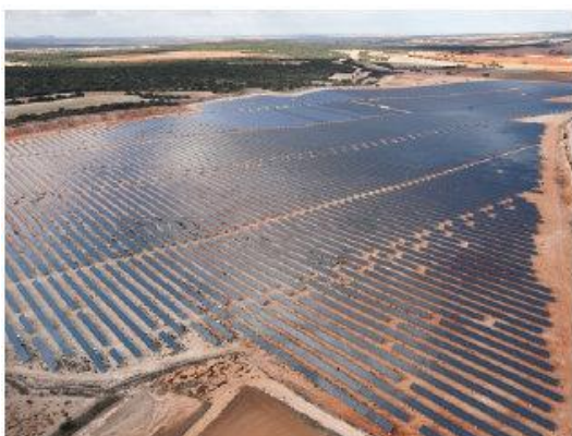
ドゥルシネア太陽光発電所（クエンカ県）
